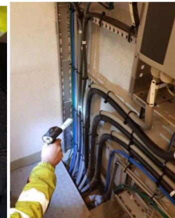
Figur 20 Presisjonsblåser i teknisk rom
