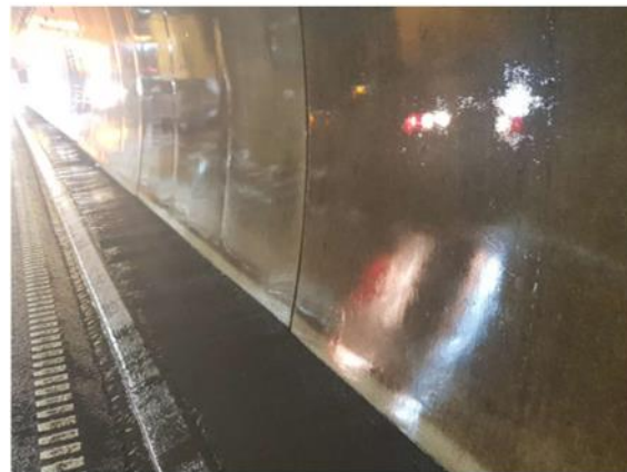
Figur 23 Betongvegg i Rælingstunnelen etter vasking (med såpe og børsting) av vegger.
