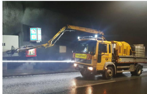
Uniarm til å vaske installasjoner
